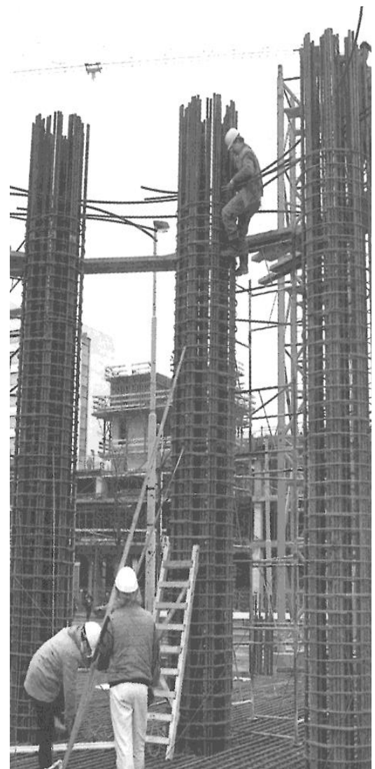
شکل ۲: آرماتورگذاری ستون‌های طبقه همکف به قطر ۵ متر که بصورت متقارن در قسمت بیرونی پلان به فرم نیم دایره قرار دارد
